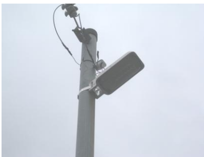
平成 24 年度より、市内の防犯灯、街路灯約 11,000 基を LED 灯に転換。集合住宅共有スペースの照明の LED 化補助も実施予定。
