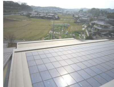
市内公共施設に太陽光発電システムを設置。平成 25 年度末 7 施設(設備容量 92kW)。写真は北コミュニティセンターISTA はばたき。
